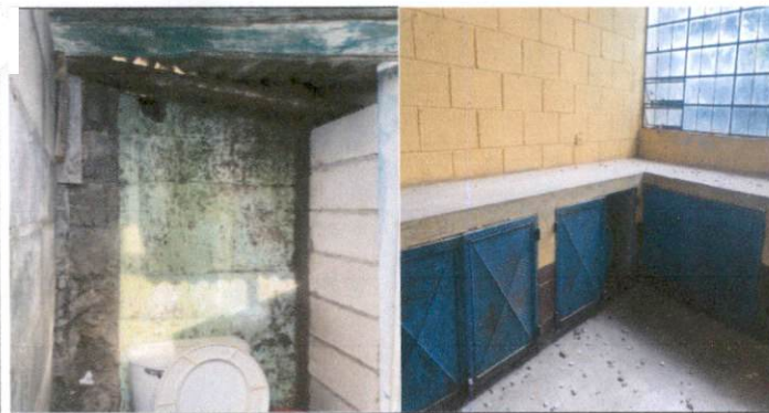
Foto 5: Sustrucción de Azulejo
