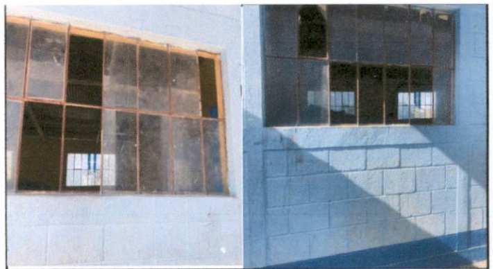
Foto 4: Sustrucción de vidrios
